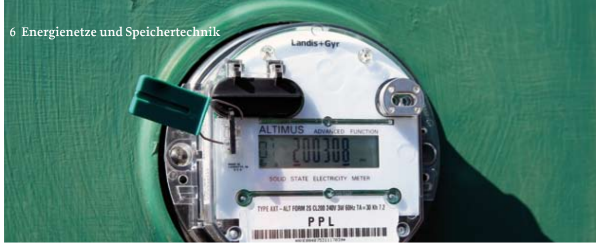
Elektronische Stromzähler versorgen die Leitstellen mit wichtigen Informationen.
